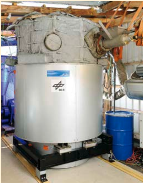
Abb. 2 Die Abbildung zeigt den untersuchten Latentwärmespeicher im Technikumsmaßstab.
